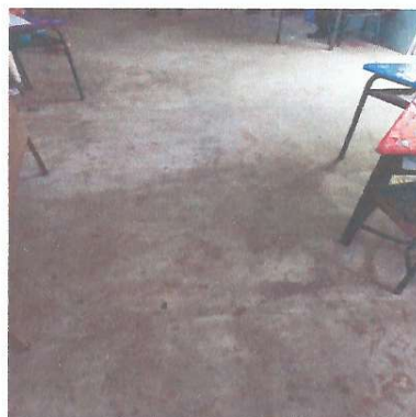
Foto 4: Piso de aula No. 2
