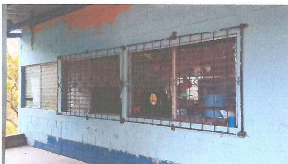
Foto 3: .ventanas y balcones aula No. 1
